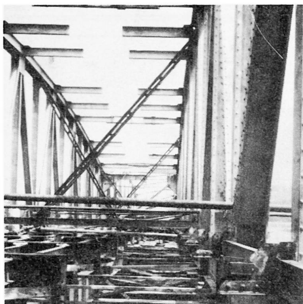
Fig.8. Déplacement des poutres
