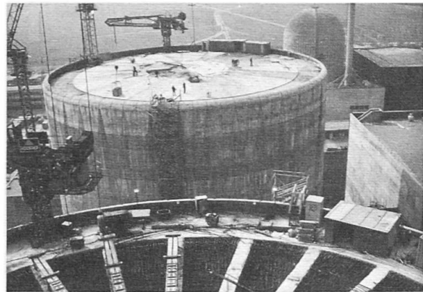
Bild 6 Der letzte Schritt war das Betonieren der Zwickel zwischen den Radialbalken und der oberen durchgehenden Betonschicht vom Zentralbereich her. Aus dem Speichenrad mit untenliegender Platte entstand schliesslich, wie im hinteren Teil der Abbildung zu erkennen ist, eine Kreisplatte.
