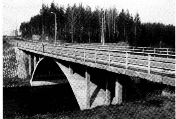
Fig. 1 The Käyräjoki bridge before repairing
