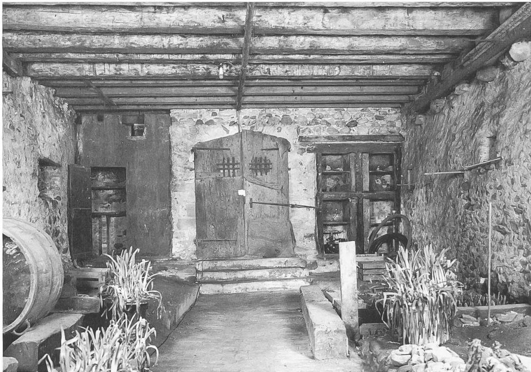
Fig. 40. La cave du n° 35 de la rue du Midi vue vers son entrée, avec son plafond de 1342-43.
