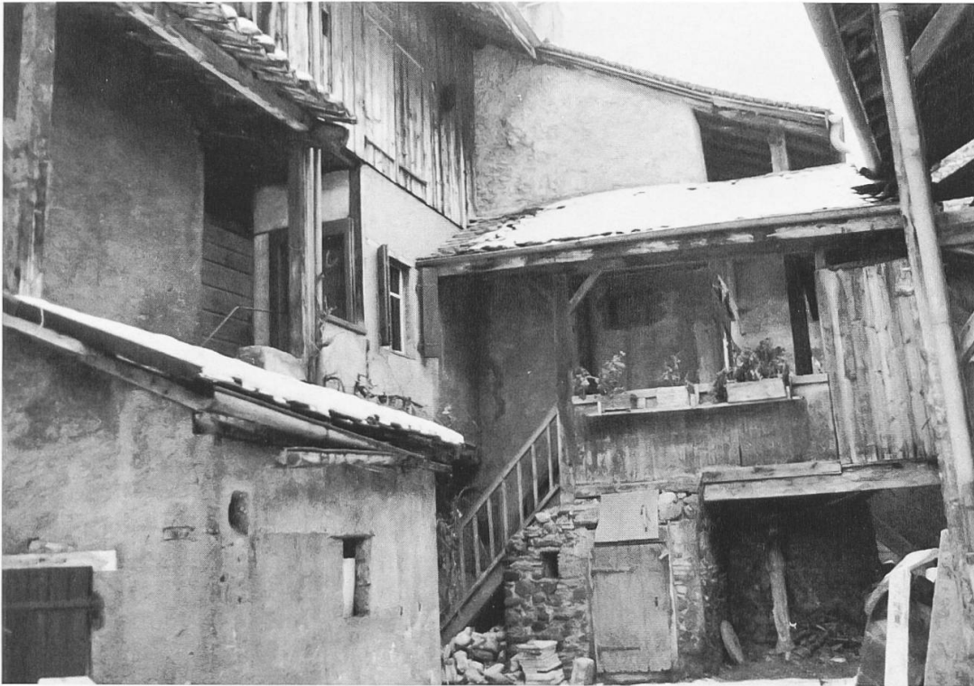
Fig. 53. Galerie de bois qui se trouvait autrefois dans la cour derrière le n° 27 de la rue du Midi (coll. CIG).
