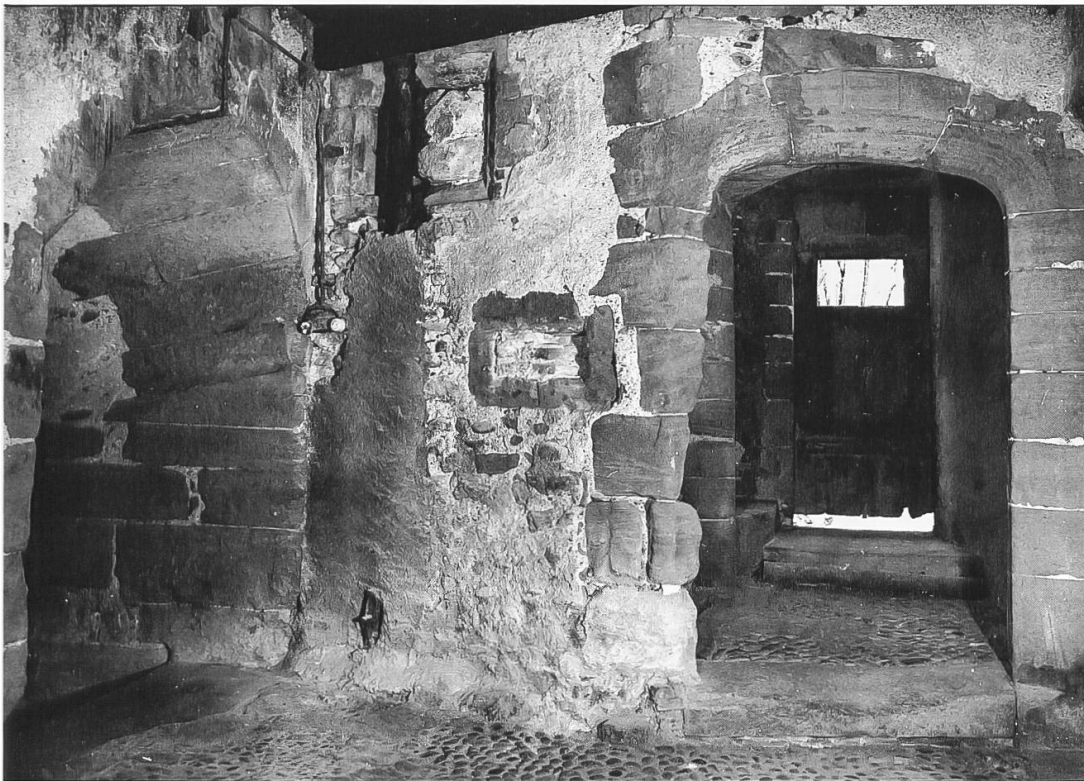
Fig. 39. Entrée de la cave et baies de l'escalier à vis du n° 35 de la rue du Midi.
