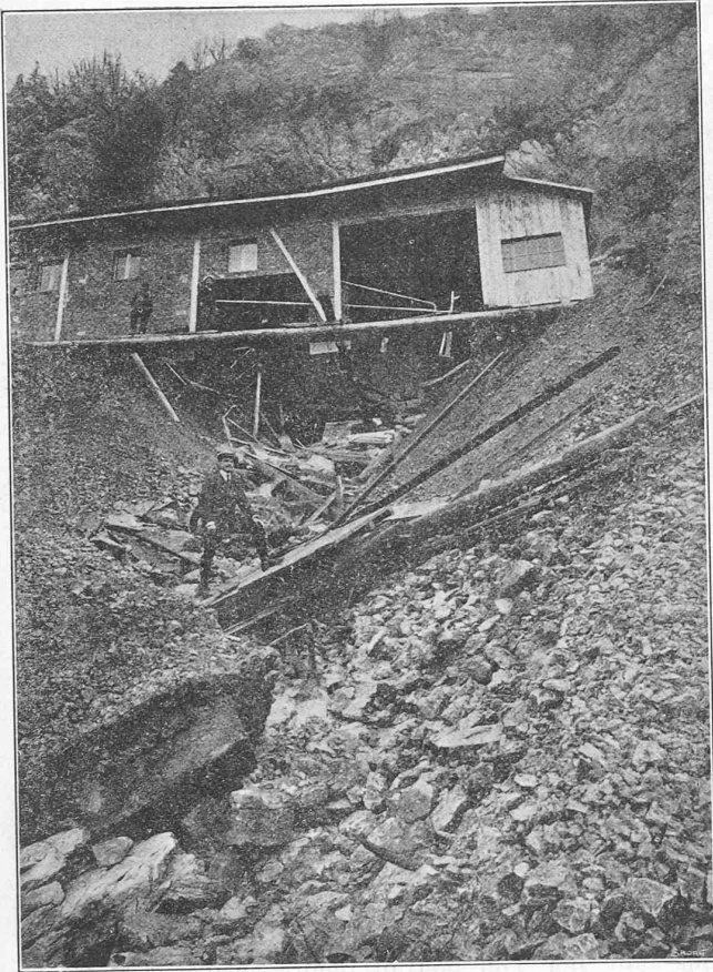
Fig. 24. — Le bâtiment des bains, après l'inondation.
