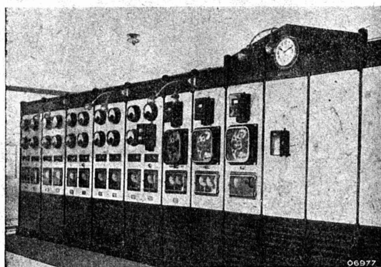
Centrale de Buenos-Aires; tableaux de distribution
