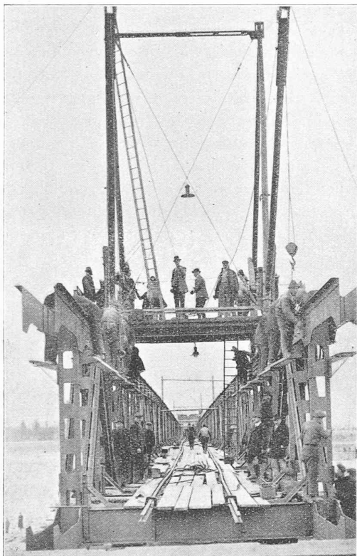
→ Fig. 18a. — Pont système Zelisko-Roth-Waagner, à 4 parois. Montage du pont provisoire près de Buchs (territoire de Lichtenstein).
