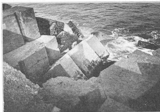
Fig. 4. — Talus extérieur de la jetée de Casablanca.
