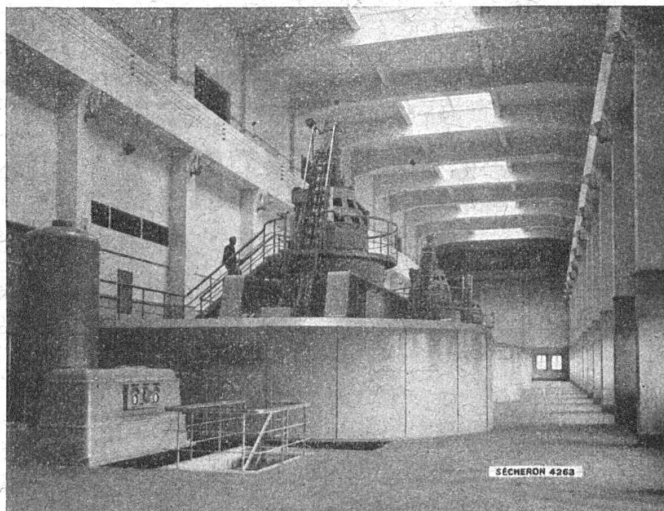
Centrale hydro-électrique de Verbois s. Rhône. Trois alternateurs triphasés de 27 500 kVA, 1800 V, 50 pér/s, 136 t/mn, de construction entièrement soudée.
