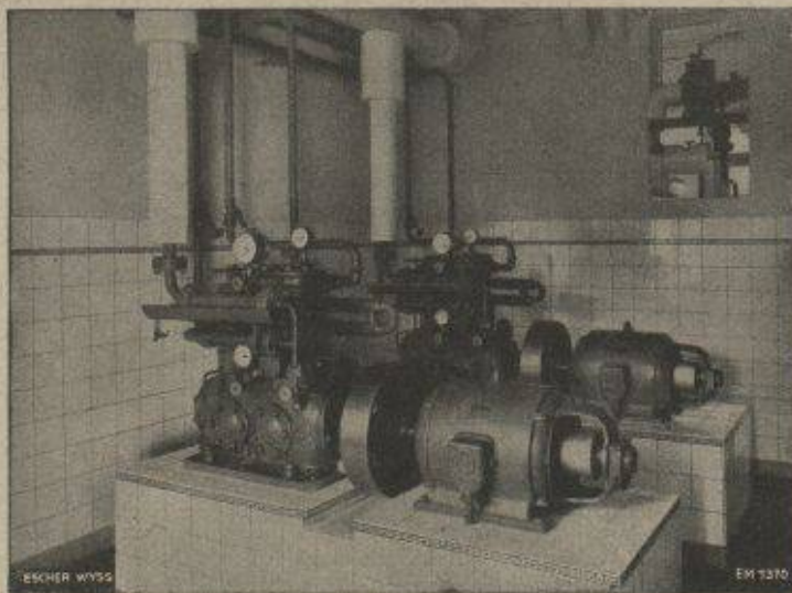
Installation frigorifique "FRIGOTROP" entièrement automatique dans une brasserie.
