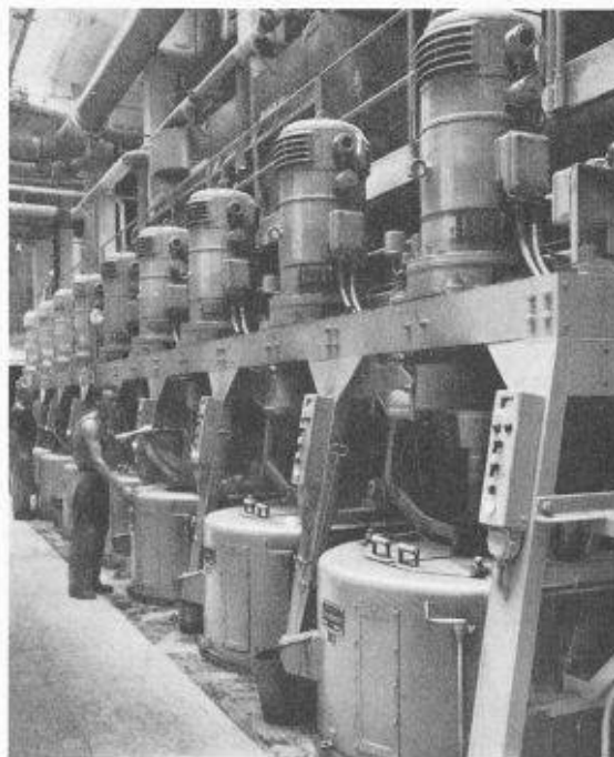
Fig. 2. — Centrifuges de grande puissance de la raffinerie d'Aarberg avec moteurs isolés au « Vetrotex » (BBC).
