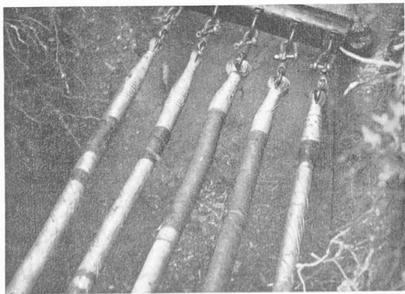
Fig. 14. — L'extrémité tirée des câbles.
