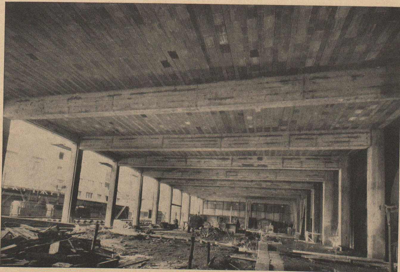
Agrandissement du Palais des Expositions, Genève : sommiers en béton précontraint et dalles préfabriquées précontraintes STAHLTON Arch. : E. Martin. — Ing. : Froidevaux et Weber. — Entr. : Ed. Cuénod S. A.
