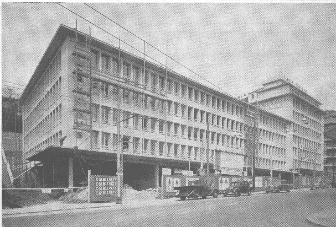
Bâtiment en cours d'achèvement, de l'hôtel Terminus à Lausanne. Oeuvre de l'architecte Ch.-F. Thévenaz. Les fenêtres sortent des ateliers de la Fabrique Coopérative de Menuiserie à Renens.
