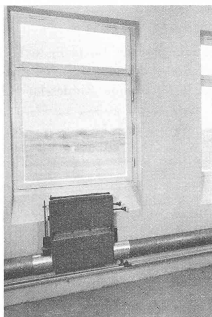
Fig. 11. — Appareils « Velovent » en cours de montage. La conduite d'air primaire est déjà en place.
