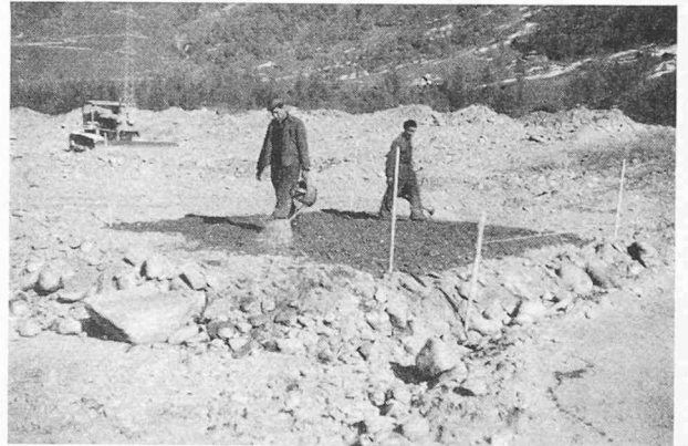
Fig. 6. — Arrosage d'un champ délimité par quatre piquets : épaisseur de la couche avant compactage 40 cm environ. Eau répandue en une fois. Au fond, le bulldozer au travail.
