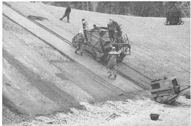
Fig. 17. — Pose de la première couche de 4 cm du tapis étanche suivant la ligne de pente.
