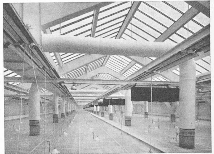
Fig. 13. — Le vide de toiture, avec le réseau de distribution des gaines d'air climatisé ; les raccords sont en matière transparente. En haut, à gauche, vue partielle d'un gros amortisseur de bruit.
