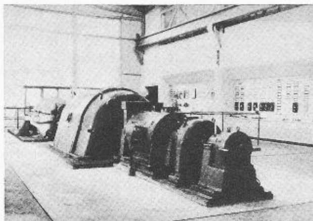
Fig. 7. — La turbine de 6000 kW de Coburg.
