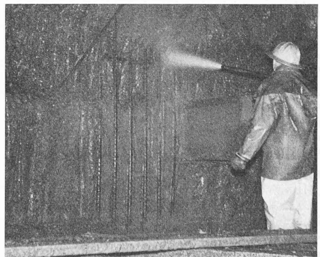
Fig. 12. — Nettoyage de la paroi. Apparition de l'armature dans une zone défectueuse.
