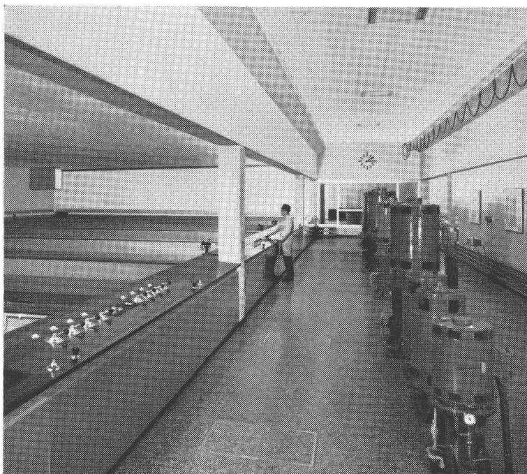
Installation de filtres rapides de Champ-Bougin, appartenant à la ville de Neuchâtel, pour le traitement d'eau du lac en eau potable. Capacité 1800 m 3 /h.
