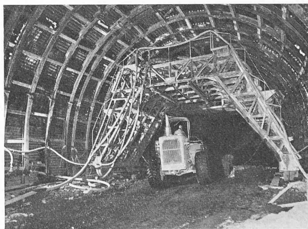
Fig. 9. — L'étagage métallique et le chariot destiné à la mise en place du béton d'étagage.
