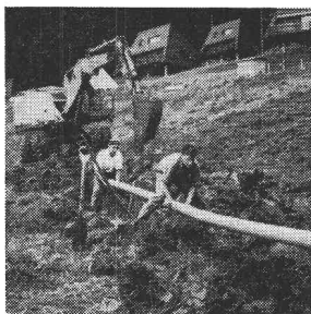
Canalisation Schwyz: Rothenturm
