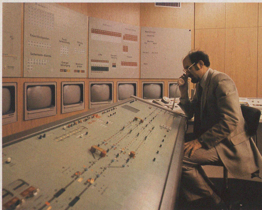
Fig. 8. — Station de commande.
