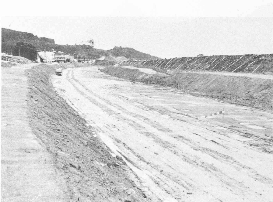
Fig. 6. — Vue sur la future N1 dans le Breitfeld, à l'ouest de Saint-Gall. A droite, on reconnaît les rubans grâce auxquels les feuilles d'étanchéité synthétiques ont été tirées sur les talus. Ces rubans ont également servi à la fixation des feuilles d'étanchéité. Ensuite, après la pose de la couche protectrice de sable de 20 cm d'épaisseur, on a commencé la mise en place des remblais, clairement visibles à gauche et à droite sous forme de bermes, au milieu du tracé il manque encore une partie du remblayage.
