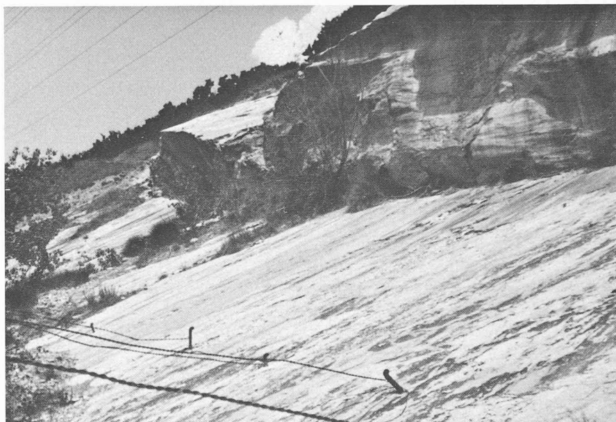
Fig. 11. — Vue de la falaise en mouvement et du plan de glissement, avant le début des travaux d'assainissement.
