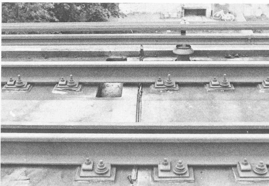
Fig. 4. — Rails continus au-dessus d'un joint du tablier au viaduc de Westmont.
