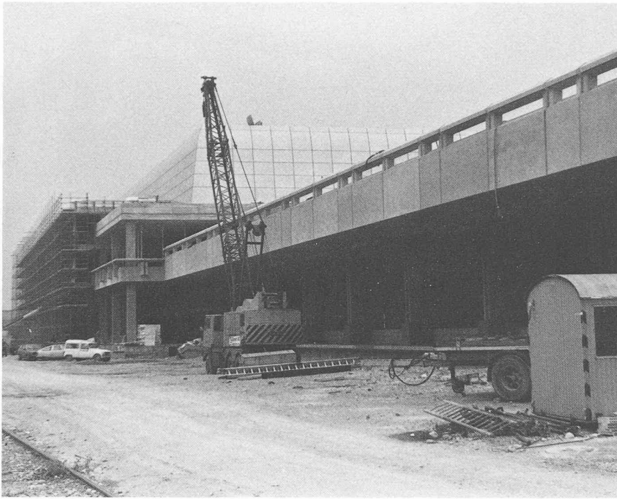
Fig. 7 — Autre vue de la façade est, montrant le corps du bâtiment d'exploitation (à gauche) et une partie de la gare postale (à droite).
