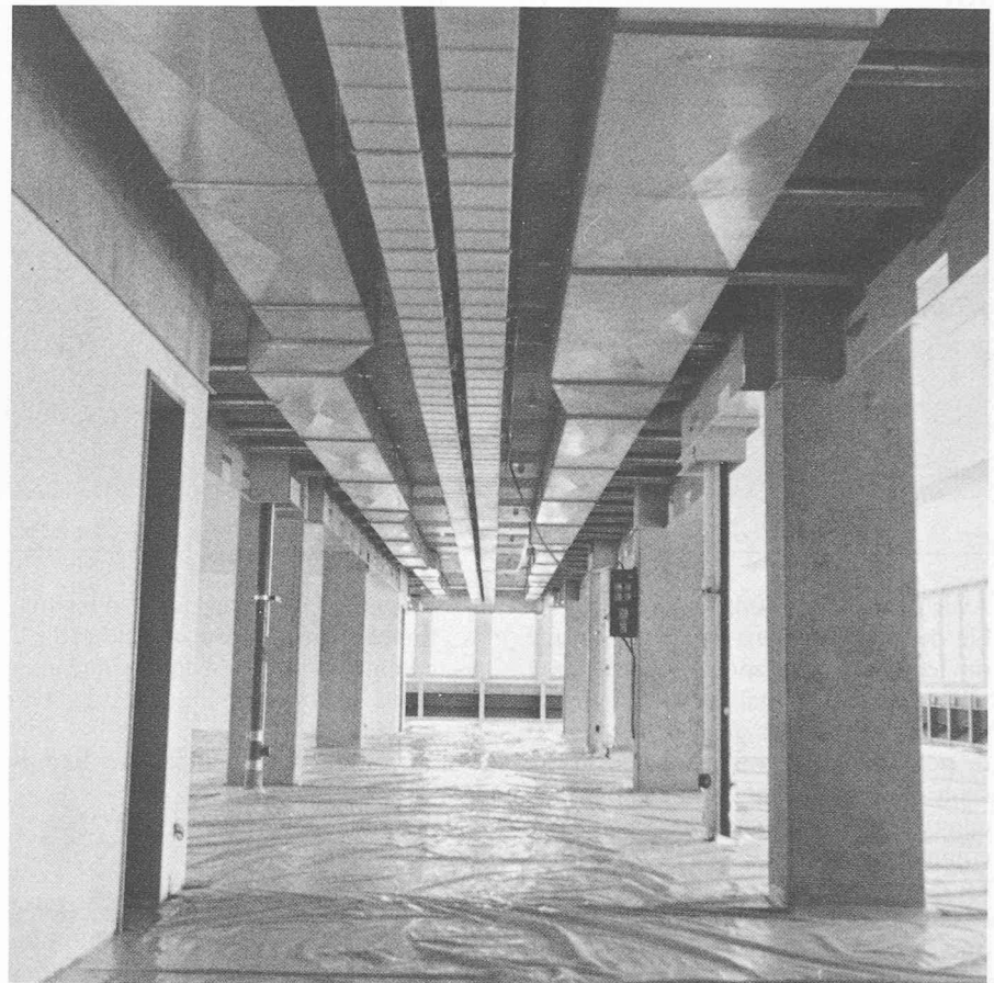
Fig. 21. — Canaux de distribution électrique et de ventilation dans faux plafonds des corridors.
