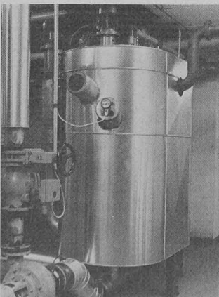
Echangeur de chaleur boues-boues de Sulzer pour une utilisation optimale de l'énergie dans la prépasteurisation des boues d'épuration.
