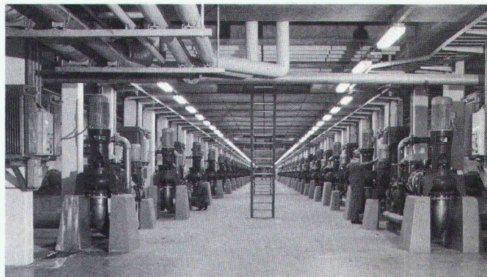
Installation d'épuration Lynetten, Copenhague, 115 pompes TURO.
