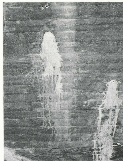
Fig. 4. — Efflorescence du béton.
