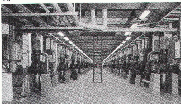
Installation d'épuration Lynetten, Copenhague, 115 pompes TURO.
