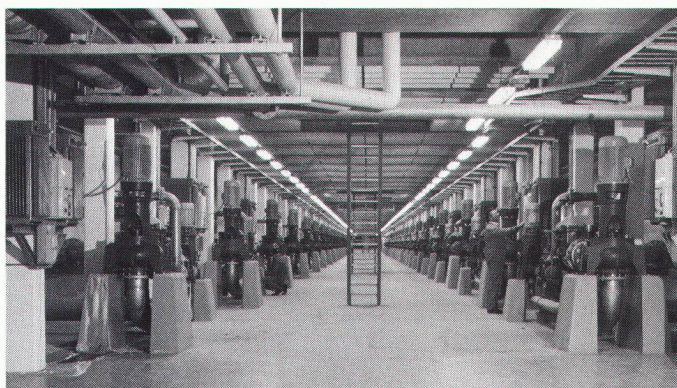
Installation d'épuration Lynetten, Copenhague, 115 pompes TURO.
