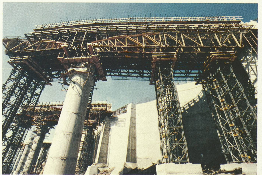
Fig. 14. — Le système d'échafaudage utilisé pour la réalisation des sommiers sur les piles ne dépassant pas 30 m.
