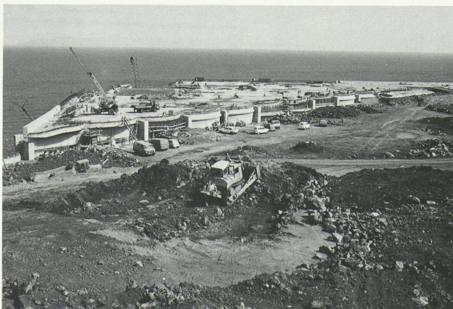
Fig. 17. — La plate-forme triangulaire en cours de finition et avant la fin du remblayage. On voit encore le mur de soutènement avec ses voûtes verticales.
