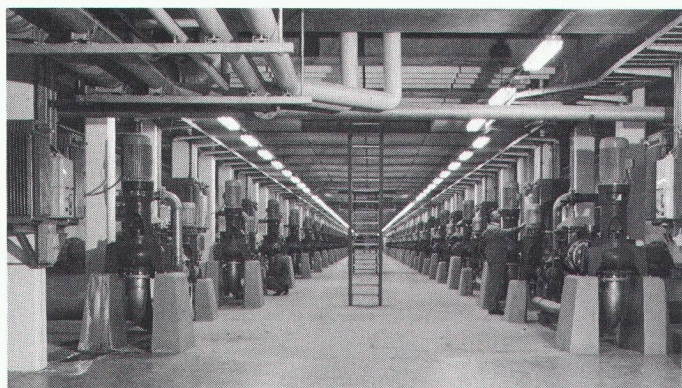
Installation d'épuration Lynetten, Copenhague, 115 pompes TURO.
