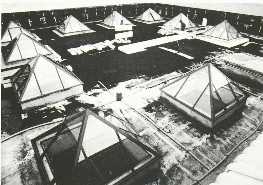
La mise en place des couches drainantes et filtrantes, du réseau drainflex et du terreau sur la toiture compacte.
