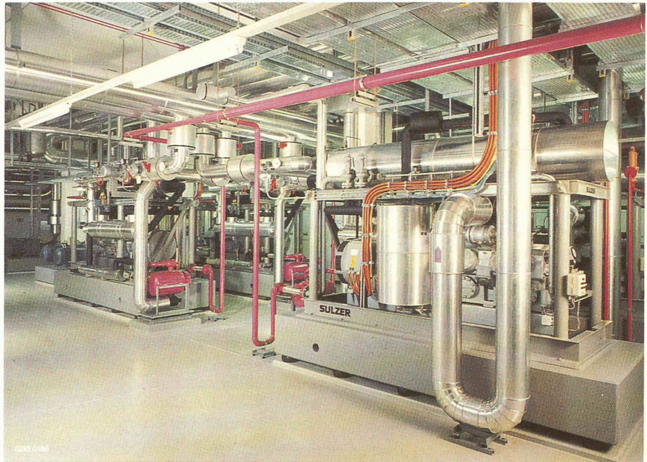
Fig. 2. — Centrale de pompes à chaleur: les unités à moteur électrique reposent sur des socles en béton, eux-mêmes disposés sur des amortisseurs de vibrations.
