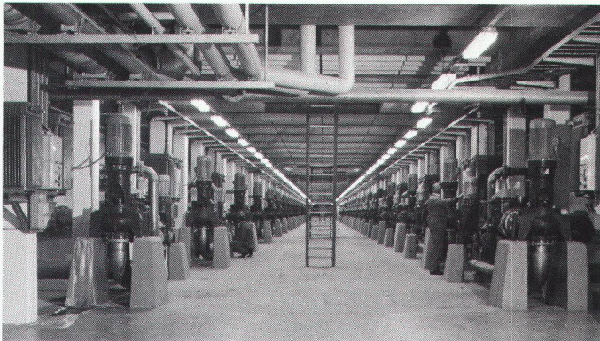
Installation d'épuration Lynetten, Copenhague, 115 pompes TURO.
