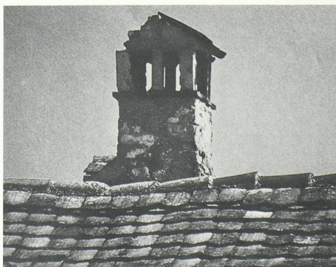
Fig. 2. - Dégâts à la cheminée, dus à la condensation des gaz de fumée.
