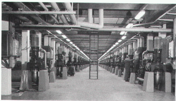
Installation d'épuration Lynetten, Copenhague, 115 pompes TURO.
