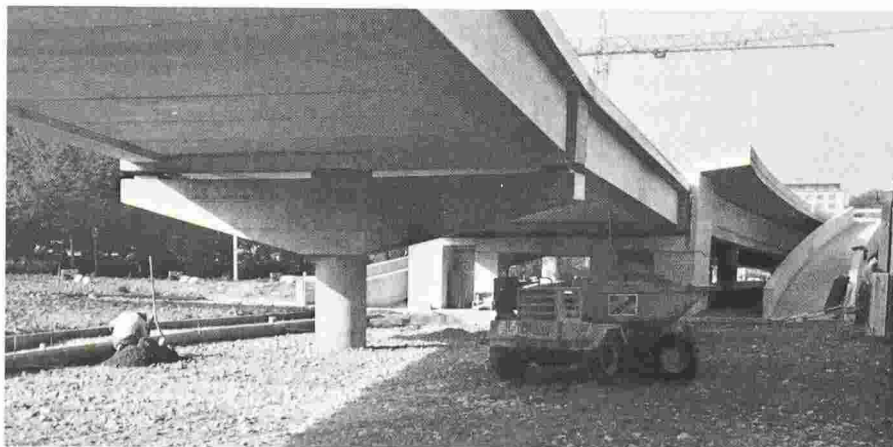
Fig. 12. - Le viaduc de Sévelin (au premier plan) et la station en pont de Montelly reposent sur une culée commune.
