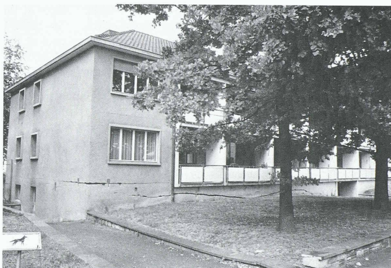
Fig. 3. – Façade rue et mur pignon coupés par une fissure horizontale
