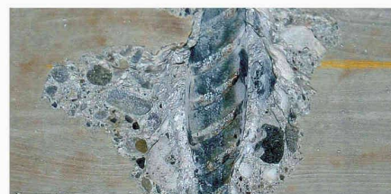
Sondage dans la face inférieure de la dalle. Pratiquement pas de corrosion malgré le faible recouvrement.
