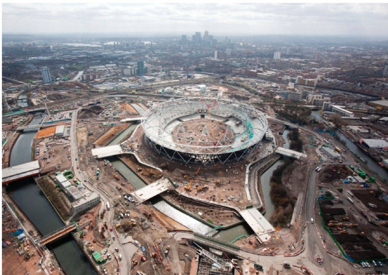
Vue aérienne du parc olympique de Londres en chantier, sécurisation des accès et du stade par les enceintes d'eaux (London 2012)
