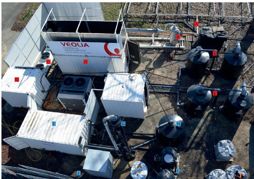
7 Ouvrages de traitement des vapeurs vus sur site (source Veolia) :
