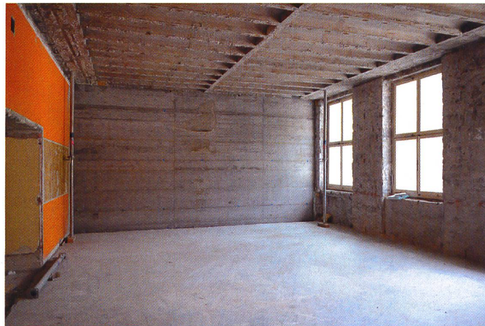
Ecole Quader de Coire: respect du patrimoine et sécurité sismique (photos Karin Vonow)
