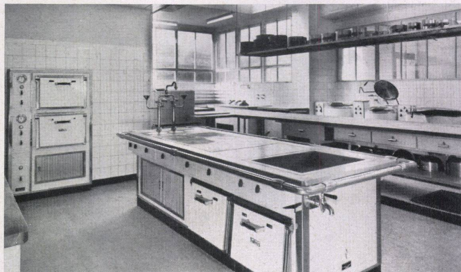
Restaurant Simmenthalerhof, Thun Groß-elektrischer Herd mit Koch- und Wärmeplatten, Wärmeschrank und Backöfen Hintergrund Kippessel und Bratpfannen Salvis AG., Luzern-Emmenbrücke
