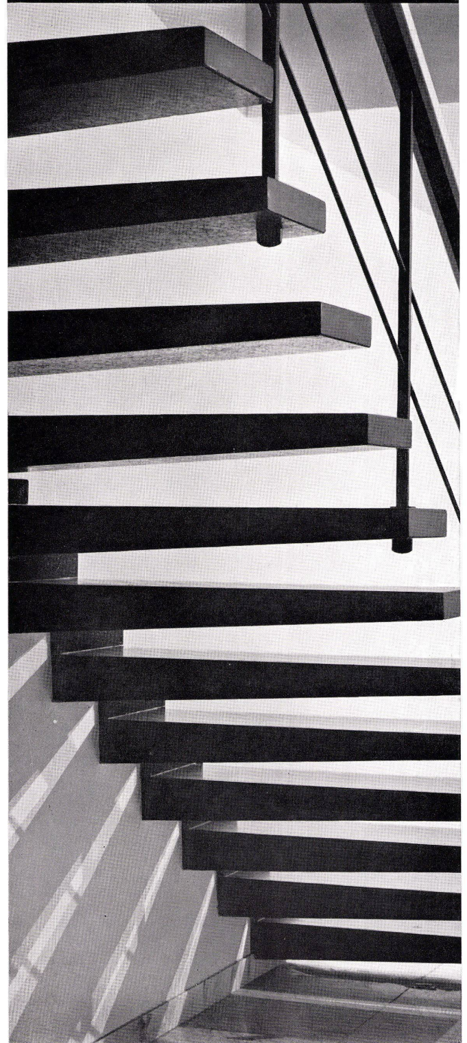
Einseitig eingespannte auskragende Trittplatten in Basler Privathaus Burckhardt Architekten BSA SIA, Base!
