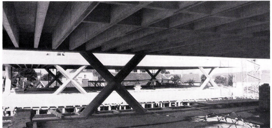
3 Stahlbetonstruktur mit Untersicht. Structure en béton armé avec vue des dessous. Reinforced concrete structure as seen from below.
