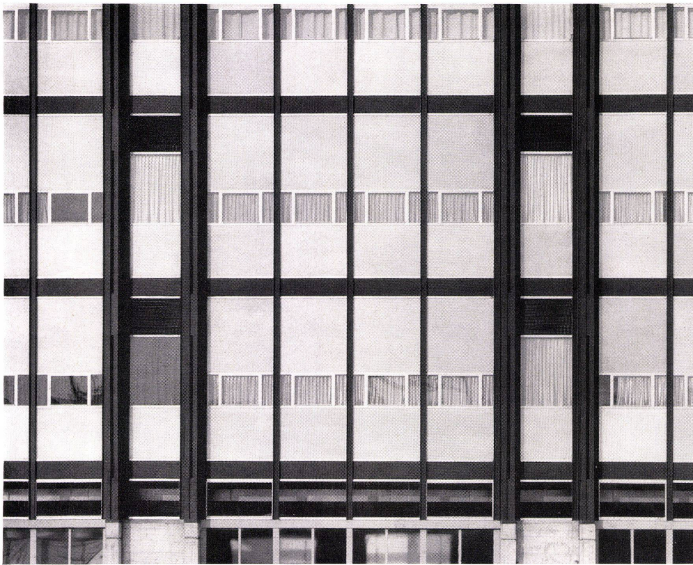
1 Heizungskamin und Kühlturm vorn, dahinter die Südostfassade der Buchbinderei mit dem Haupteingang. Cheminée et tour de refroidissement en avant. Derrière, la façade sudest de la reliure avec l'entrée principale. Chimney and cooling tower, in front; behind, the southeast face of the bookbindery with the main entrance.
